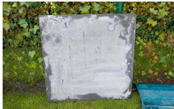
Een tegel werd weggehaald om na te gaan of het tegelwerk werd uitgevoerd volgens de regels van de kunst
